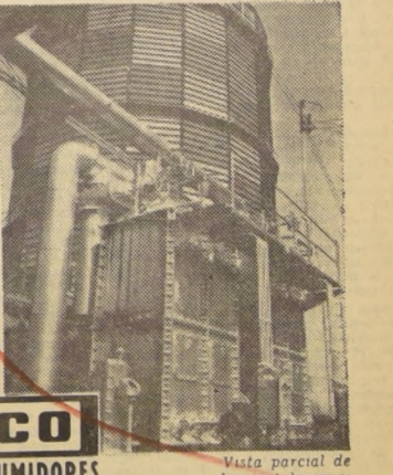
Vista parcial de las instalaciones de purificación
