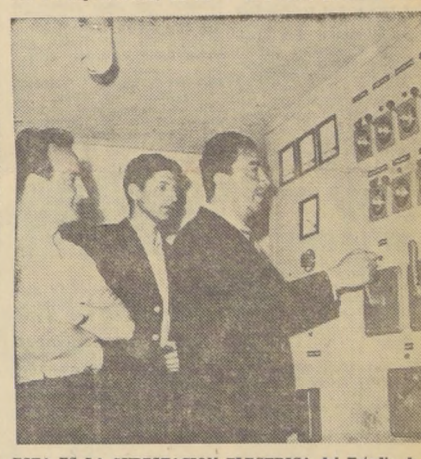
ESTA ES LA SUBESTACION ELECTRICA del Estado de la Técnica. Según los entendidos es la planta más completa del país. Hace funcionar las palancas Edmundo Gutiérrez, gentil cicleron en nuestra visita al campo deportivo. Observa el Administrador Alamos y Pletikosis.
