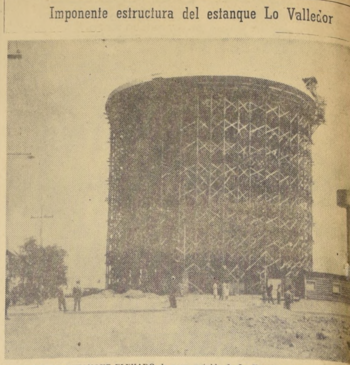
EL NUEVO ESTANQUE ELEVADO de agua potable de Lo Vallecór, que beneficiará a 150.000 pobladores del Gran Santiago, muestra aquí su imponente estructura metálica y de concreto. Este gigantesco estanque —que cuenta con una capacidad de 4.000 metros cúbicos— fue inaugurado el jueves pasado en un acto que contó con la asistencia de autoridades. El valor del estanque con sus impulsiones es de 500.000 escudos y abastecerá a las poblaciones Lo Vallecór, Norte y Sur; La Feria Norte; La Feria Sur; Victoria; Santa Adriana y otros sectores marginales. En el grabado, se muestra aún con gran parte del andamiaje que se ocupó en su construcción.
