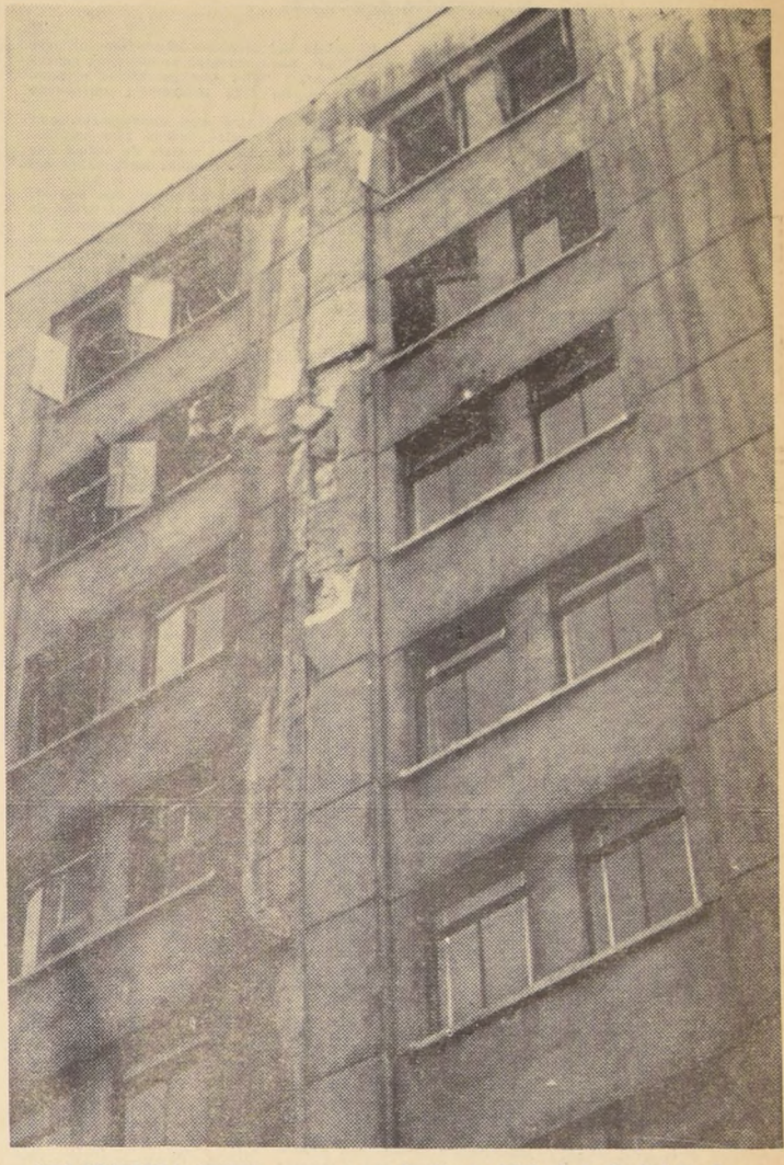
UNA PROFUNDA GRIETA muestra en su frente el edificio de la Contraloría General de la República, una de las construcciones fiscales de Santiago que mayores perjuicios recibió con el sismo del domingo.
