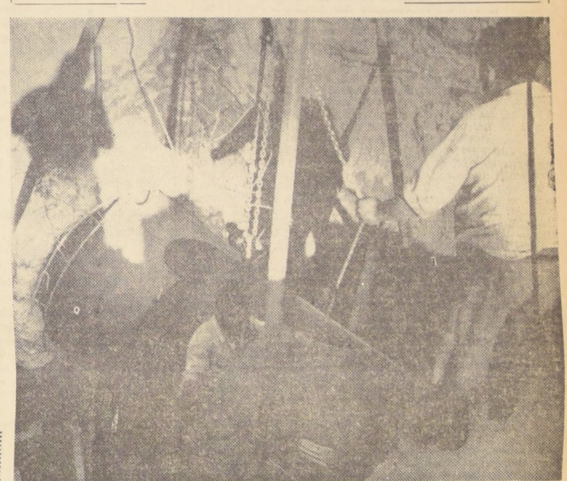
OBREROS DE LA DIRECCION DE OBRAS SANITARIAS reparan una de las roturas que produjo el sismo en el sector Pachacama del acueducto "Las Vegas". Estas faenas han permitido regularizar el suministro de agua potable en Valparaíso y Viña del Mar.
