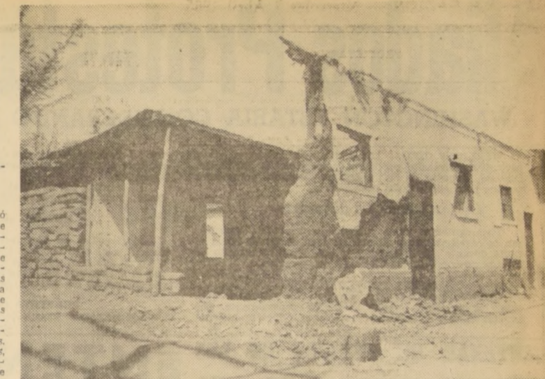
LA CRUZ.— CASAS DAÑADAS.— La fachada quedó en pie, pero el derrumbe de una pared lateral dejó al descubierto la estructura total del inmueble...
