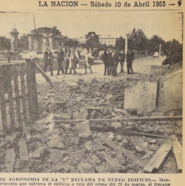
FACULTAD DE AGRONOMIA DE LA "U" RECLAMA UN NUEVO EDIFICIO— Mostrando la destrucción que sufrió el edificio a raíz del sismo del 23 de marzo...
