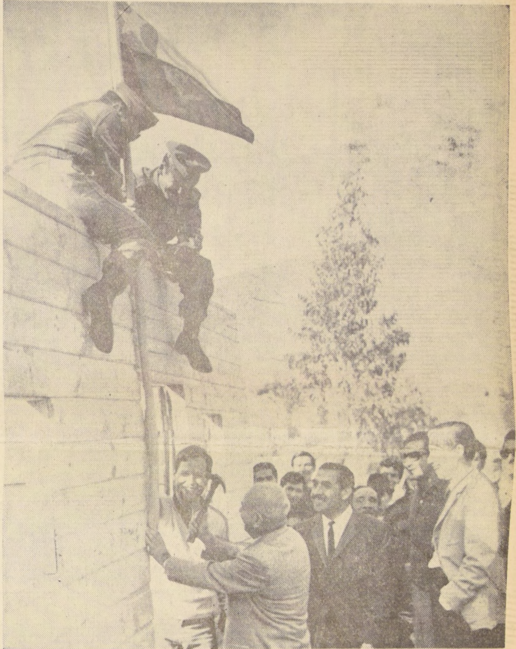
EN SOLO 25 minutos fue levantada ayer en La Liga la casa número 7 mil, que traduce el acelerado ritmo con que se está realizando la rehabilitación de la zona dañada por el sismo del 28 de marzo pasado. El Ministro de Obras Públicas, Modesto Collados, quien aparece junto al Ministro en Campaña, Juan de Dios Carmona, clavó el mástil donde flamea la bandera chilena. Observan la escena, estudiantes y obreros. La vivienda siete mil, que aparece en el grabado, se entregó ayer mismo al poblador Galindo Mancia, padre de cuatro hijos. Durante esta ceremonia la multitud jubilosa, entonó el Himno Nacional.
