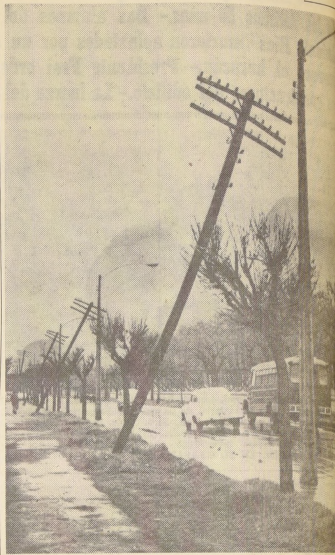
EN AVENIDA SANTA MARIA, al lado del río Mapocho, la postación de telefonía quedó seriamente dañada. EL GRABADO muestra la hilera de postes de madera caídos por el fuerte impacto del viento. Los cables quedaron inutilizados y la Compañía de Telégrafos tuvo que realizar reparaciones de urgencia.
