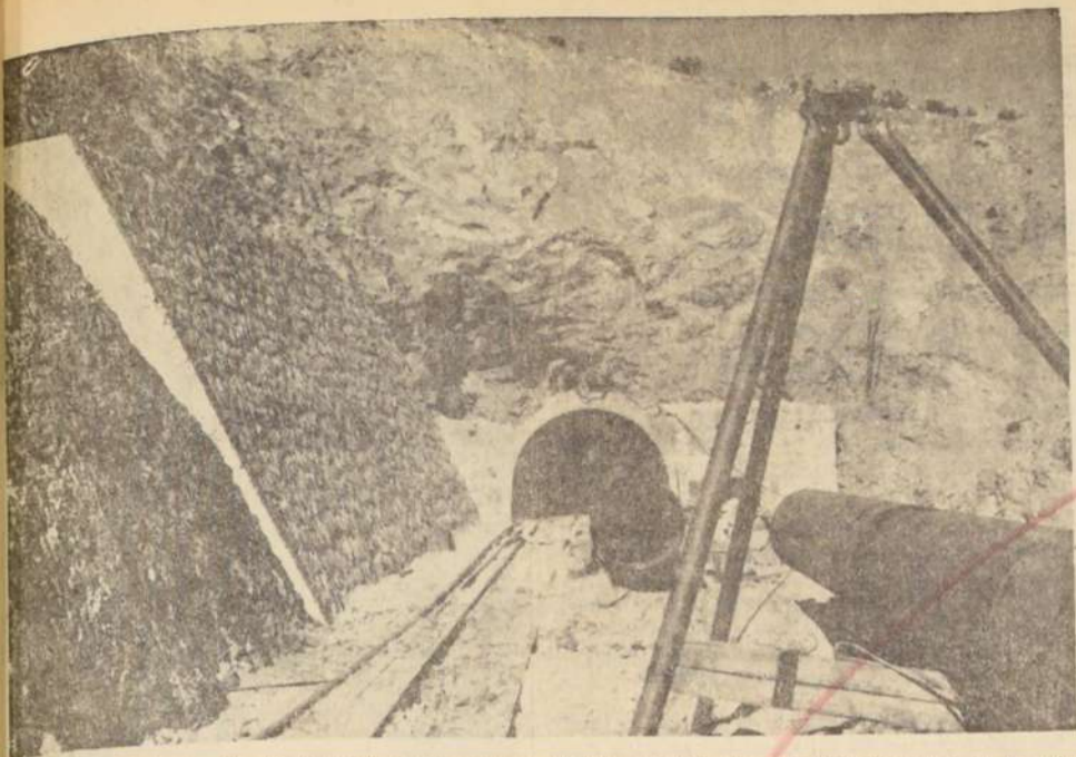
Construcciones de túneles, de vías férreas y caminos son la preocupación mayor de la Junta de Adelanto de Arica. que ha convertido al puerto limitrofe en uno de los más modernos del país.
