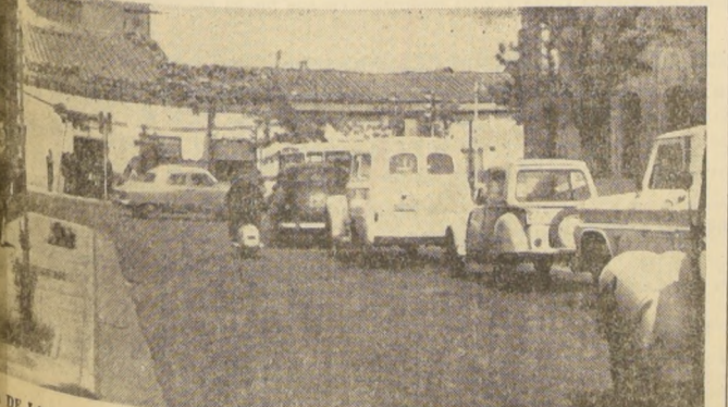
DE LAS OBRAS urbanísticas más importantes que cambiará parte del rostro de la ciudad de Santiago, se inició ayer. El Alcalde de Santiago, con su presencia simbolizó la labor de demolición que se está realizando en la zona que ocupa el Hospicio de Santiago, en calle Portugal y que permitirá la prolongación de la Avenida Paraguay, la que empalmará con la Avenida Lira hacia Portugal.
