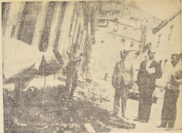
VALPARAISO.— ALCALDE EN CALLE CAJILLA.— Una nueva visita de inspección a la calle Cajilla, del sector puerto, realizó el Alcalde de Valparaíso, Juan Montedónico, con el fin de verificar la forma en que se están efectuando los trabajos de pavimentación ordenados para el referido punto. EN EL GRABADO, el Alcalde Montedónico, observando las faenas que realizan obreros municipales en las reposiciones de soleras de la calle.
