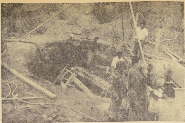
Nuevos pozos de captación de aguas están siendo excavados en el Valle de Azapa, y servirán para abastecer en forma normal de agua potable a la población de Arica. En el grabado, obreros de Obras Públicas efectúan el drenaje de un pozo de riego para el Parque Brasil de esa norlina ciudad.
