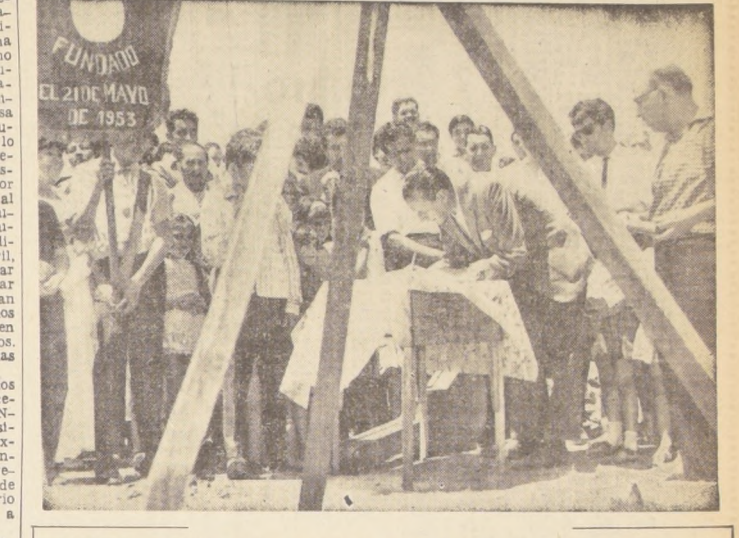
Vecinos de Peñalolén inician los trabajos de construcción de su Centro Comunitario, el que levantarán con sus propias manos y con el apoyo de la Promoción Popular.
