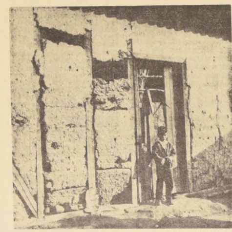
Así son las "casas" que el fundo "San José" de Paine proporciona a sus trabajadores. Contigua a ellas están las "chancheras" con el consiguiente peligro sanitario para los numerosos niños que allí habitan. Los hoyos que se observan en los muros de adobes...
