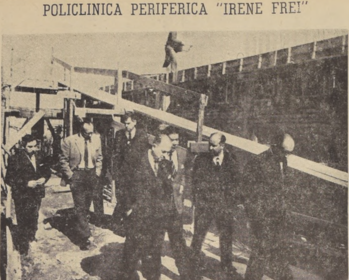
PANAGUA.— Tres policlinicas periféricas se están construyendo en la ciudad de Rancagua para descongestionar la atención de enfermos en el Hospital Regional. El Supremo Gobierno ha adoptado esta determinación en vista del aumento de población...
