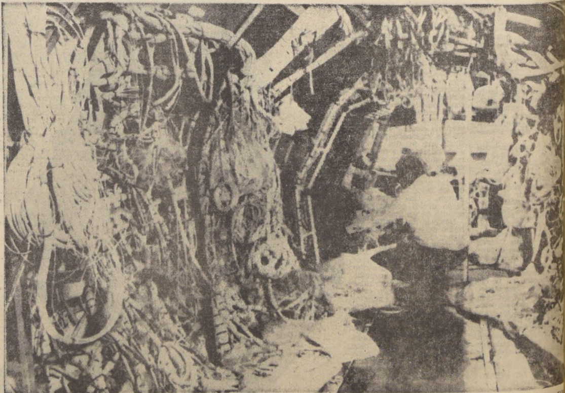
El prototipo franco británico "Concorde" se encuentra en las últimas fases de su construcción, actualmente en Gran Bretaña, después del proceso inicial de armamento realizado en Francia. La foto muestra la enorme maraña de los doscientos cuarenta kilómetros de cables electrónicos, entre los cuales los técnicos parecen perdidos, pero en realidad perfectamente cómo realizan las conexiones necesarias para que el "Concorde", cuyas características, tanto de velocidad como de capacidad de transporte y seguridad de vuelo son revolucionarias, emprenda en febrero su primer vuelo de prueba. (Foto UPI).
