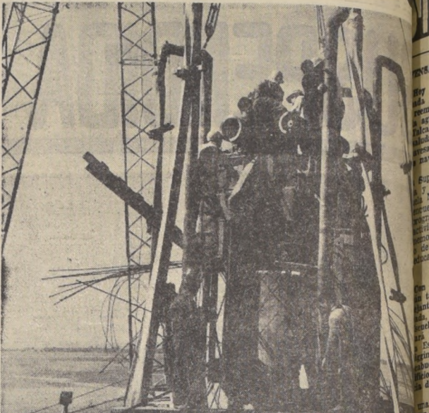
Técnicos y trabajadores enterraron uno de los pilotes —en el grabado— de sustentación, importante en el desarrollo de la obra, que permitirá el tránsito de 48 mil vehículos por día.
