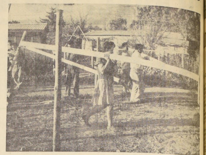
Las mujeres también quisieron cooperar y ayudaron en el traslado de los tubos. Con esta primera etapa se da comienzo al convenio realizado entre la cooperativa de la Población John F. Kennedy y la Dirección de Servicios Sanitarios para la autoconstrucción de la red de alcantarillado.
