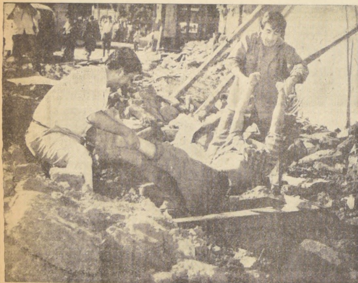
Tres obreros perecieron al derrumbarse un muro del inmueble ubicado en calle Marceña 424 de esta capital. Las víctimas, trabajaban en la demolición de ese edificio. El grabado muestra el instante en que se retiraba uno de los cadáveres.
