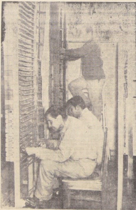
Personal de la Compañía de Teléfonos de Chile trabaja en obras de ampliación de la central telefónica de Quilpué.
