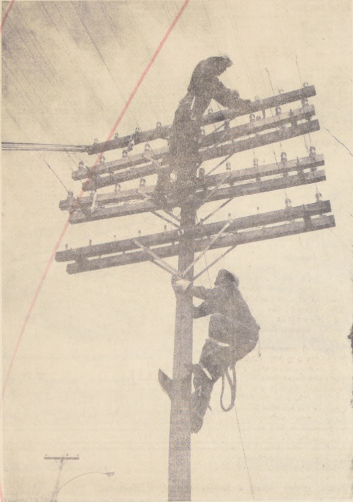
Dos funcionarios de la Compañía de Teléfonos de Chile revisan cables aéreos en el sector de la planta automática en Pedro de Valdivia. El plan de ampliaciones que se ha puesto en marcha, gracias a un convenio entre el Gobierno y la Compañía de Teléfonos de Chile no descuida el aspecto de mantención de los equipos ya existentes.
