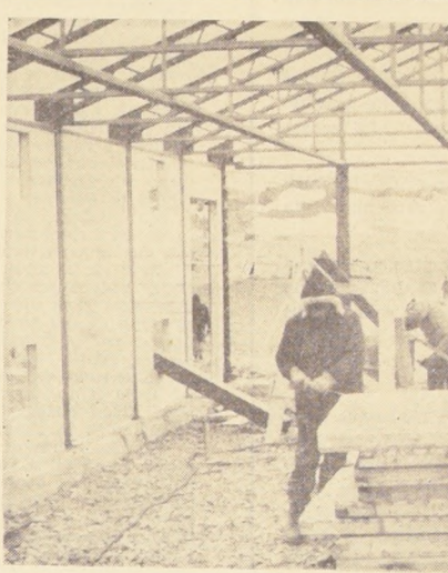
MAÑANA, a las 8 horas, se espera la llegada del Presidente Frei a la base en construcción de la FACH en Bahía Fildes, isla San Jorge...
