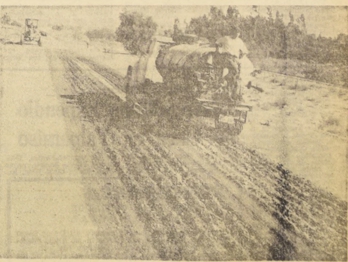
LA SERENA.— TRABAJOS CAMINEROS. Tanto las comunidades campesinas y mineras, como la Dirección Provincial de Vialidad, se encuentran efectuando una activa labor para ampliar y mejorar la red caminera de la provincia de Coquimbo. En el grabado, equipos de Vialidad ejecutan trabajos en el camino de La Serena a Ovalle, por Las Cardas, el que será pronto pavimentado en 16 kilómetros de extensión.
