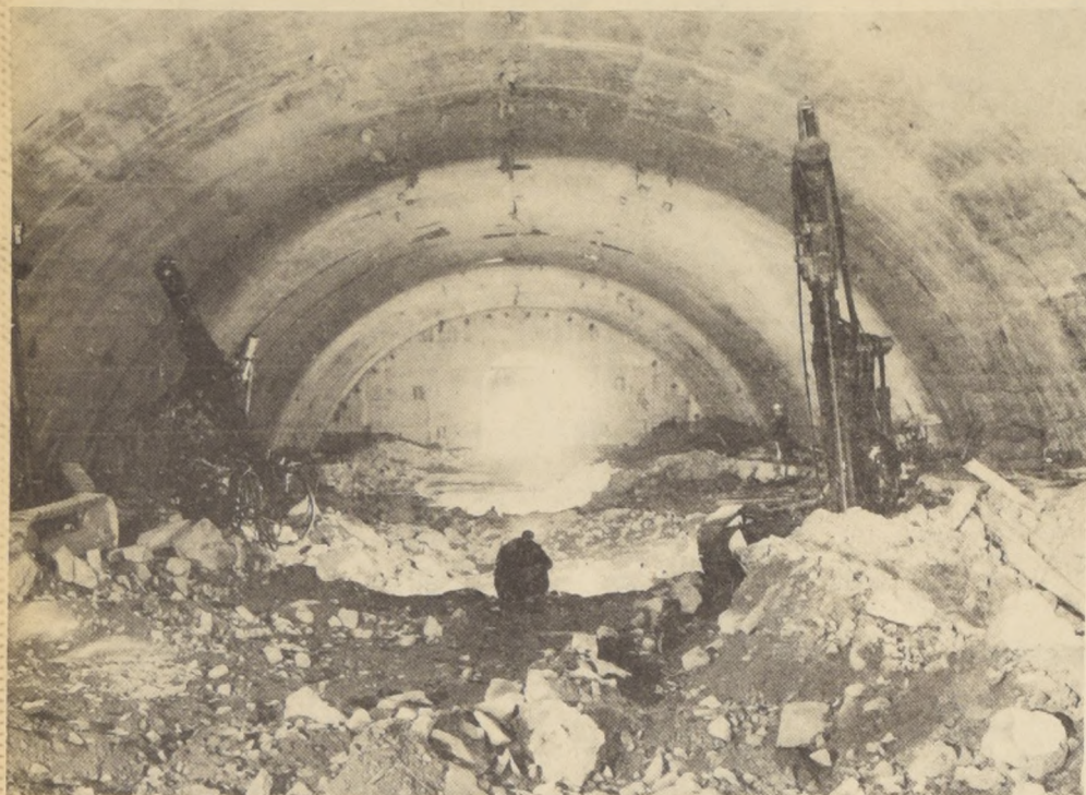
EL TORO Un aspecto de la caverna donde quedará ubicada la Casa de Máquinas de la Central Hidroeléctrica "El Toro", una de las tres nuevas Plantas que ENDESA pondrá en servicio en fecha próxima y que producirá 400.000 KW.
