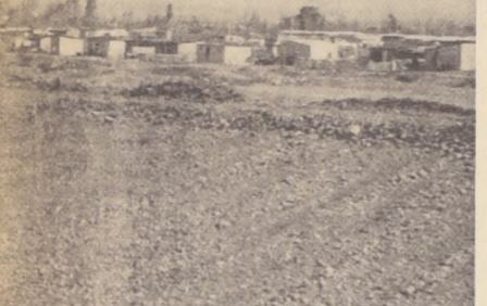
OBRAS DE DEFENSA EN RIO COLINA. Como una forma de prevenir contingencias ante posibles futuras "salidas de madre", la Dirección General de Obras Públicas realizó trabajos de defensas ribereñas en el lecho del río Colina. Las obras, que acaban de ser entregadas por el Departamento de Defensas Fluviales, beneficiarán especialmente a las poblaciones de Esmeralda y Colina, que en inviernos lluviosos resultan anegadas. Los trabajos se extienden sobre una longitud de dos mil metros y consisten básicamente en limpiar y ensanchar el curso del río, cuyo lecho revela todos los efectos de la sequía que afectó a la zona central. Su ribera fue peraltada con maquinaria bulldozer para proteger a los pobladores. En la foto, un aspecto de las obras ya terminadas.
