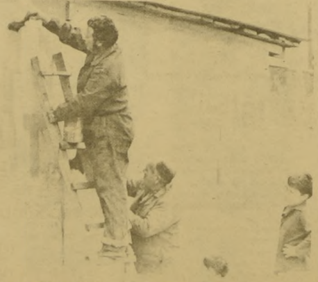
EN LOS BARRIOS se comienza a cambiarle el rostro a la capital. Vecinos de Sierra Bella pintan la fachada de una humilde vivienda que había sido rayada por extremistas.
