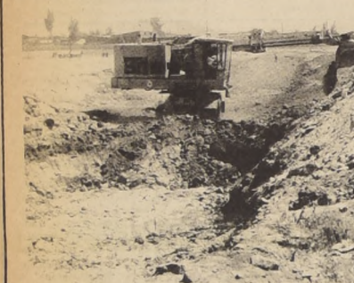
KINDERMANN OBSERVO TRABAJOS DEL METRO Durante la visita practicada por el Intendente de la Provincia, Jorge Kindermann a la comuna de Barrancas, la comitiva se detuvo a presenciar los trabajos que ejecutan grandes bulldozers en las obras preliminares del Metropolitano. Las máquinas han abierto una extensa franja en el camino de Pudahuel, sector de Pajaritos donde momentáneamente estaba ubicado el taller de Mantenimiento para después constituirse en la Estación Pajaritos de la línea 1.
