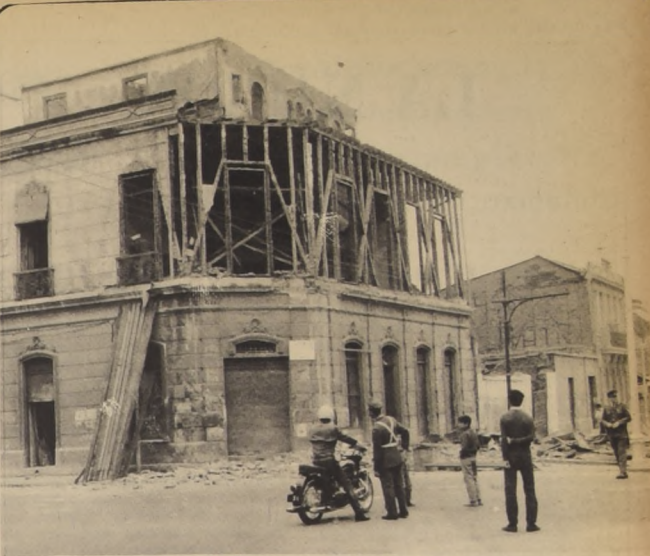
A las 8 de la mañana paralizó todo el tránsito de Teatinos con Rosas, por la demolición de la propiedad de la esquina, donde aún viven dos ancianas.
