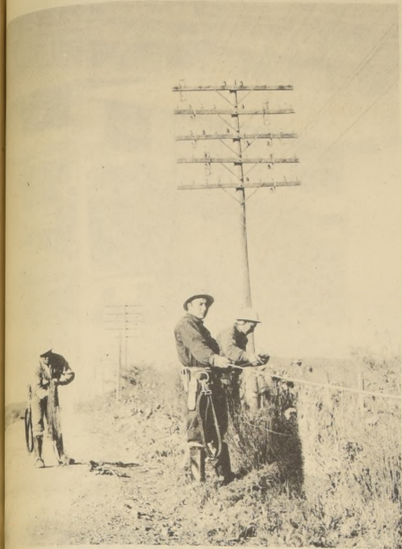
No sólo en sectores urbanos se han realizado trabajos significativos. Sólo en materia de teléfonos públicos se instalaron, durante el año pasado, nuevos medios de comunicación en 22 localidades pequeñas y en 18 poblaciones marginales de las grandes ciudades.
