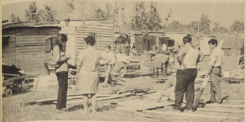
La familia Martínez, atareada, construye parte del techo de su casa, antes de que llegue la noche. Los esposos han trabajado mano a mano durante el día descansando sólo para comer.
