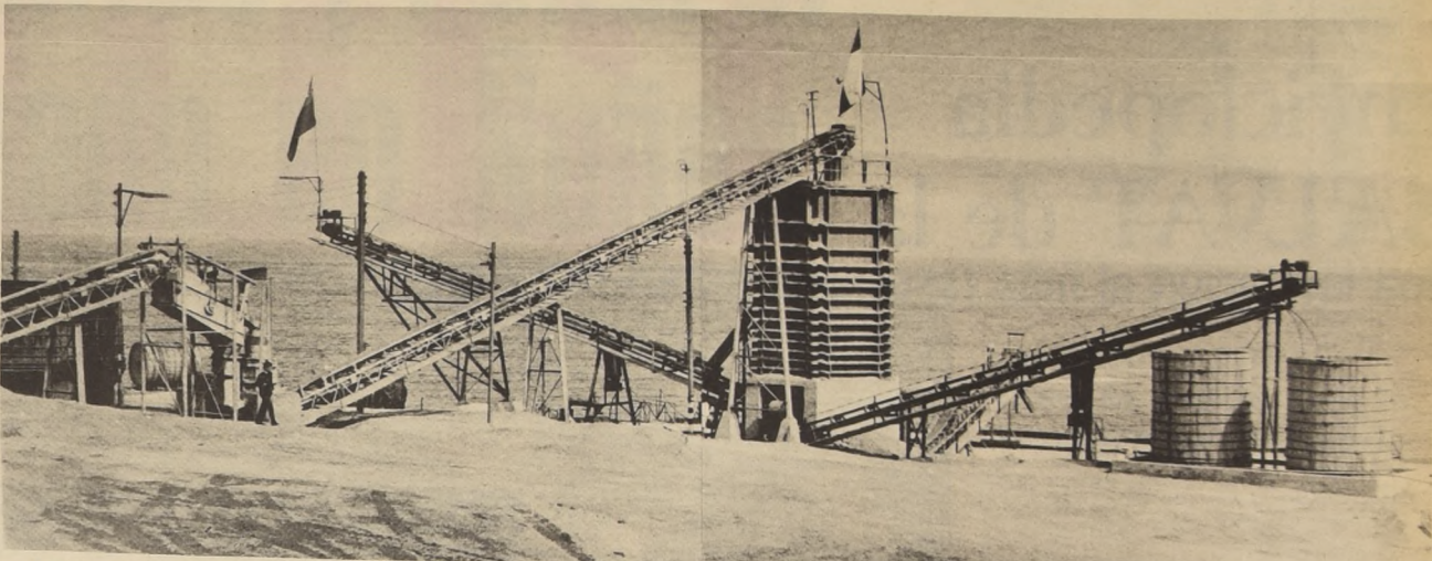
Aspecto general de la Planta Regional de Tocopilla que beneficia 6.000 toneladas mensuales de minerales de cobre de los Pequeños y Medianos Mineros de esa zona.
