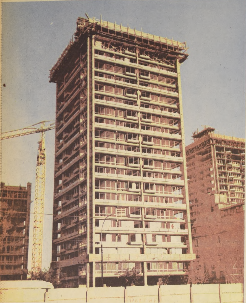
La fotocolor muestra las torres 1, 2 y 3 que construye en la Remodelación San Borja la Empresa Constructora "Viviendas Belfi Ltda." en el sector formado por la Avda. Bernard O'Higgins, Portugal y la desaparecida calle Pedregal. Por este lugar se ingresará a una de las Estaciones del futuro Ferrocarril Metropolitano.
