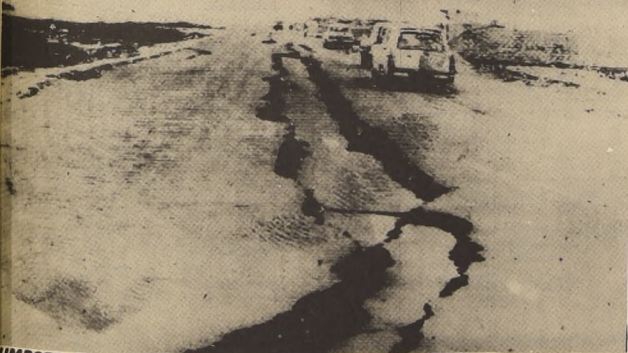
CHIMBOTE (Perú). La carretera Panamericana partida en dos por la fuerza del movimiento sísmico que sacudió al Perú, dejando devastadas millares de viviendas y causando la muerte de miles de personas. (Radiofoto UPI)
