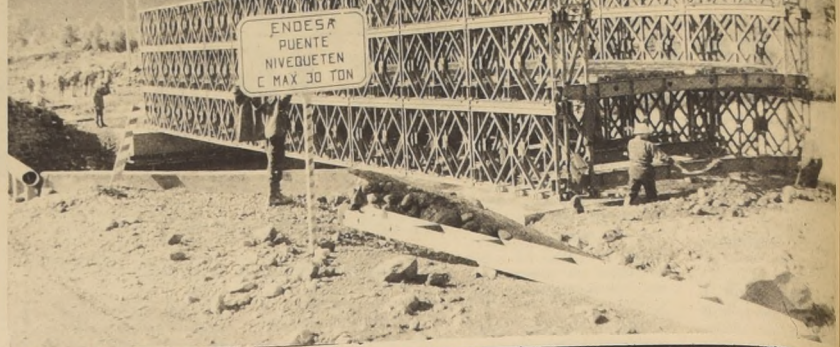
PUENTE SOBRE EL LAJA O NIVEQUETEN. En menos de un mes y medio Ingenieros Militares han levantado un puente metálico de gran resistencia en la zona cordillerana del río Laja, para permitir el paso de la maquinaria pesada que ENDESA necesita para la nueva Central Hidroeléctrica de El Toro.
