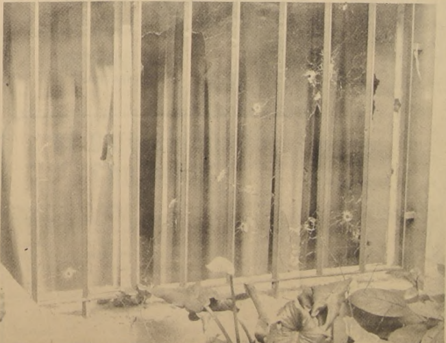
LOS CRISTALES del departamento subterráneo ubicado en Huelén 235 muestran los impactos de las balas, durante el tiroteo que policías sostuvieron con los extremistas atrincherados en ese lugar.
