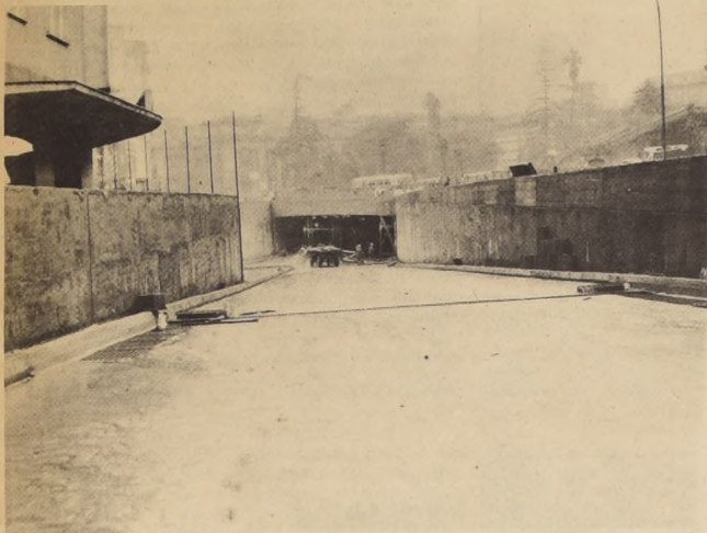
UN ASPECTO de las obras del Paso Inferior Santa Lucía, cuya inauguración
