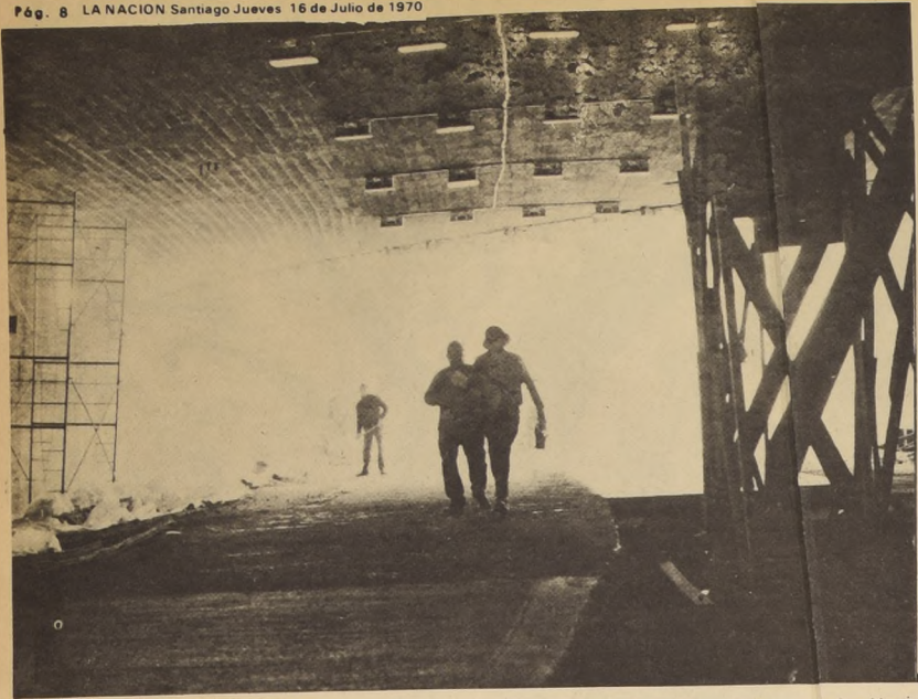
UNA hermosa vista donde contrastan luz y sombra, durante los trabajos de instalación de la iminación interior.
