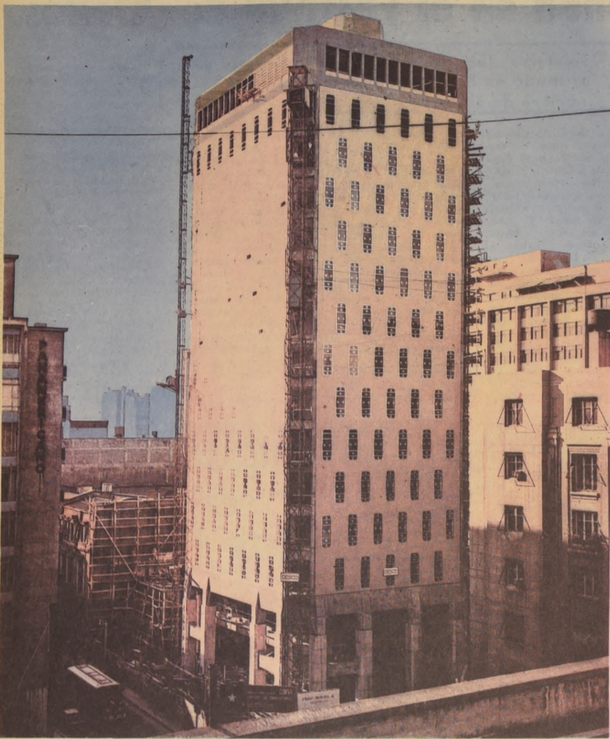
El nuevo edificio para la Caja de Previsión de los Empleados Particulares, que construye la Empresa Constructora Desco Ltda., en la esquina Nororiente de la intersección de las calles Huérfanos y Icaño, tiene dos subterráneos y 15 pisos de altura. Los seis primeros
