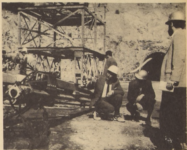
HOY ENTRARÁ EN SERVICIO - El túnel "Lo Prado" acercará más a la capital con Valparaíso, a la vez que constituye un fuerte impulso al progreso del país. La foto corresponde a una visita de inspección del entonces Ministro de Obras, Sergio Ossa.
