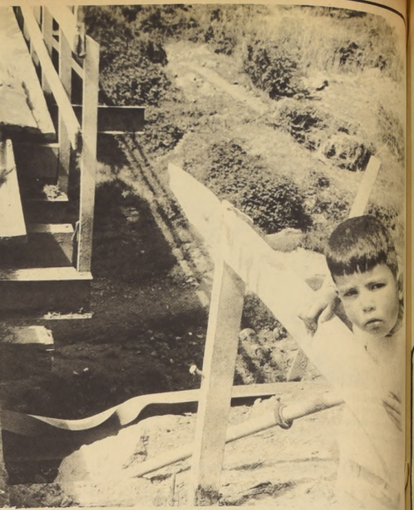
LAS BARANDAS del puente La Dehesa en Las Compañías saltaron en pedruzcos a raíz de la detonación de una bomba instalada por terroristas.
