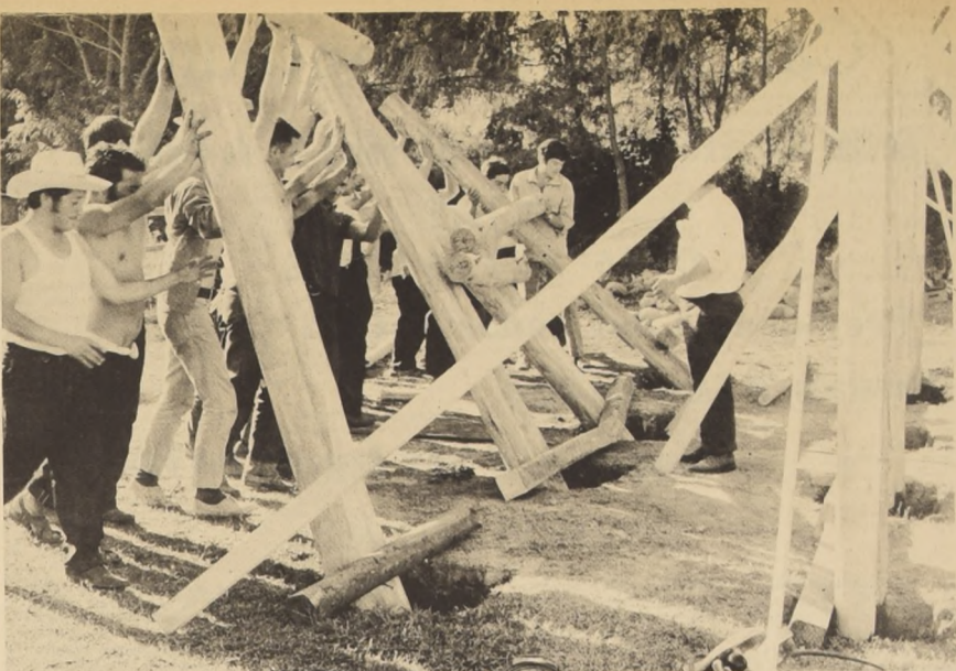
UN, DOS, TRES... listo el columpio. Los trabajadores de INDAP realizaron la obra, transformando un sitio erialo y abandonado en una bella plaza de juegos infantiles. Milagros de solidaridad y trabajo voluntario que deben imitarse a lo largo y ancho de Chile.
