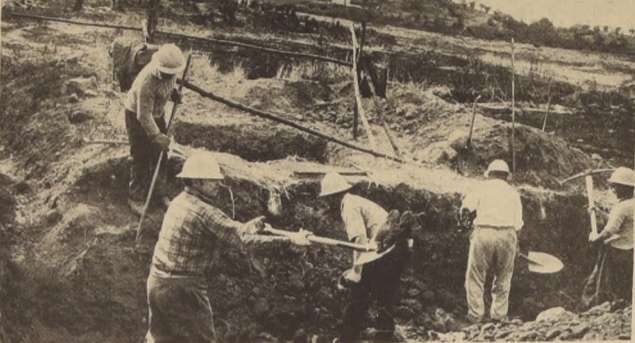
Los trabajos del canal Teno - Chimbarongo precisarán la remoción de 1.300.000 m3 de tierra. Su capacidad será de 65 m3 por segundo y su construcción durará 30 meses.
