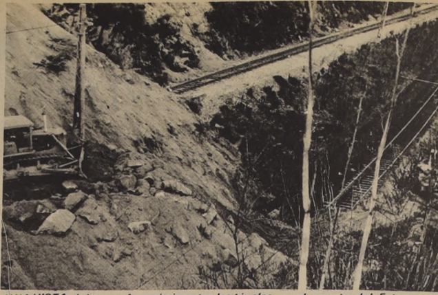
UNA VISTA del tramo ferroviario entre los túneles y el puente del Estero Marga_Marga, afectado gravemente por los sismos.
