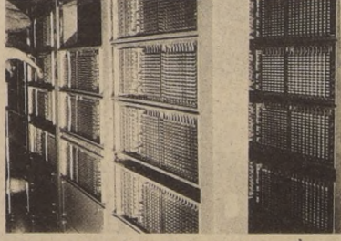
Vista parcial de una Central Telefónica Automática "Pentaconta" similar a la Central adquirida por la Ciudad Ecuatoriana Riobamba. FABRICA VICUÑA MACKENNA 3939 - FONO 515515 DEPTO. COMERCIAL: MOSQUETO 491 - OF. 612 - FONO 31131
