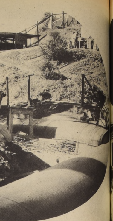
Trabajadores del Municipio porteño en la tarea esforzada y sin descanso de reconstrucción, acarrear materiales, junto a hombres de la Municipalidad de Valparaíso que colaboraron con ellos en la construcción de mediategas.
