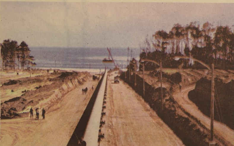
Línea Submarina: Longitud 2700 mts. Diámetro 42"
