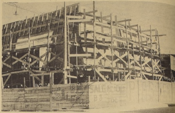
Paralizadas están las obras de construcción de lo que va a ser el "Hogar del Trabajador", en Coquimbo. Esto se debe única y exclusivamente a la irresponsabilidad de la empresa constructora que no se cuenta con el presupuesto suficiente para darle término.
