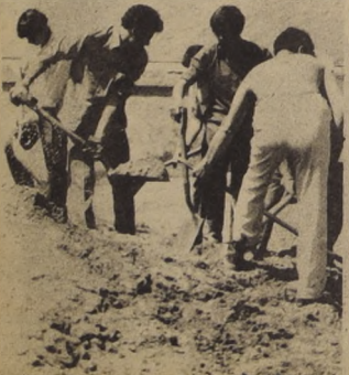
EN LA PULPERÍA. Los trabajos voluntarios estuvieron encaminados a arreglar el techo y remover algunos escombros. Más de 20 personas se entregaron de lleno a estas faenas.
