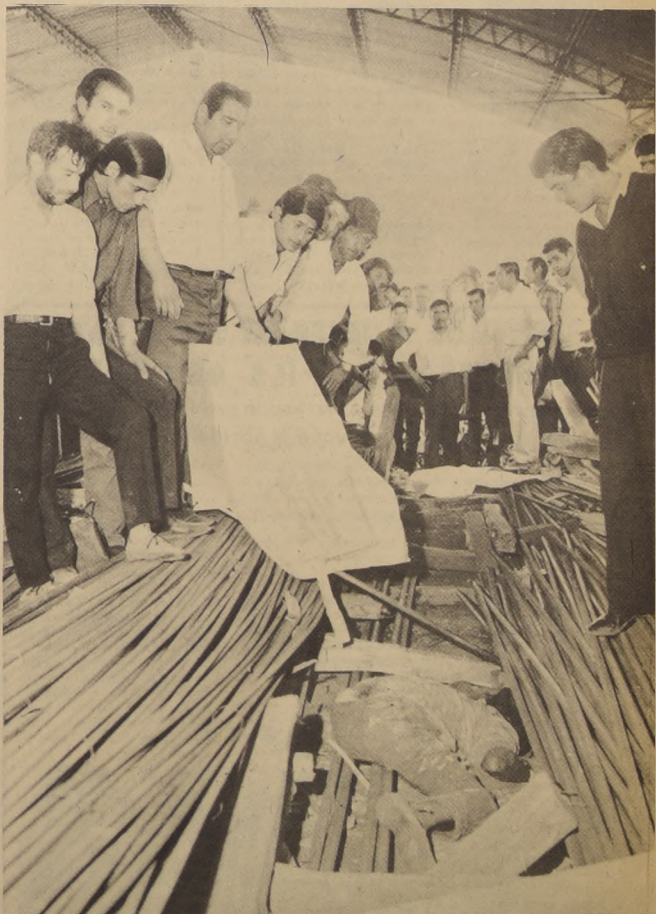
Después de más de dos horas de trabajo, junto a sus compañeros de labores pudieron destapar, de entre los fierros, el cadáver del jornalero Manuel Sánchez Venegas, de 34 años de edad, quien murió, junto a otro trabajador, al derrumbarse encima una serie de barras de más de 100 toneladas.
