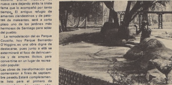
Obra en trabajos voluntarios repararon esta pérgola que estuvo botada y destruida por mucho tiempo. Ahora será un agradable lugar donde descansar.
