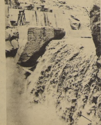
La represa de la Central Hidroeléctrica del Cañón del Pato, en Hualanca, fue objeto de reparación.
